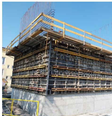
HR systém, s.r.o. - Stanoviště tlumivek, Hranice
